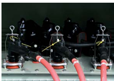
Подсоединение к трансформаторам с помощью 158LR
