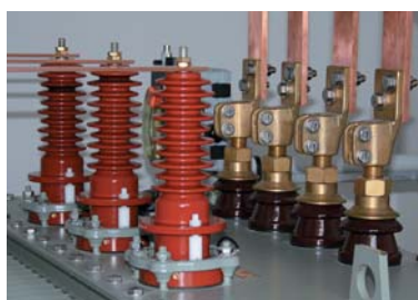
PITO-E на трансформаторах с отверстиями в корпусе
