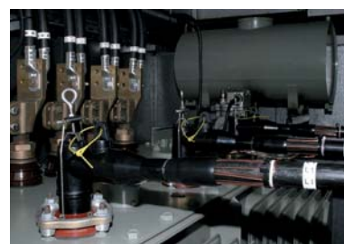
Подсоединение к трансформаторам с помощью 158LR
